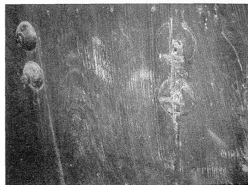
15 門を留める釘(名島門) 釘隠が落下しているの、先に一文字に開いた様子がよくわかる。ふつうは十字に開く。
