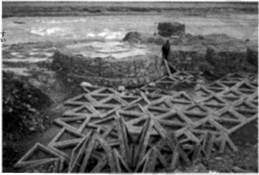
用水路水門は蛇籠（奥）と聖牛（手前）で制水
