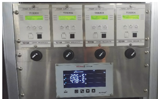
図5 真空機器用制御パネル
