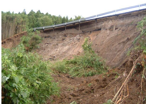
(2) 異常降雨による被災状況
